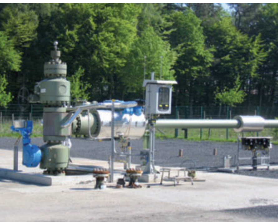
Die Systeme der Kavernenköpfe sind in die neue Leittechnik integriert
