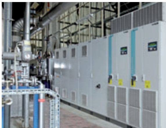
Beide Lüfter – für Frisch- und Rezirkulationsluft – werden mit einem Frequenzumrichter vom Typ Sinamics G150 angesteuert
